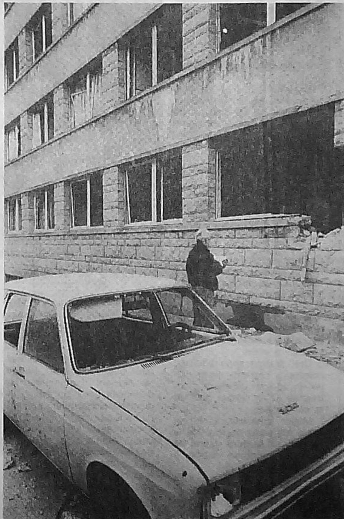
L'endroit où avait été placé l'explosif, rue d'Antrain. L'onde de choc a pulvérisé toutes les fenêtres de la façade et du collège en face.
