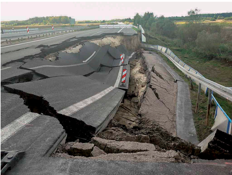
Das eingebrochene Teilstück der Trebeltalbrücke auf der A 20.
