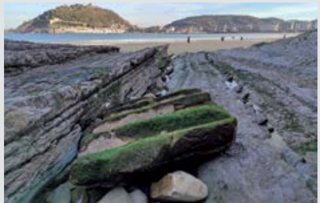
Figura 7.5. Detalle del tramo de escaleras desprendido en febrero de 2014 (31-12-2021).
