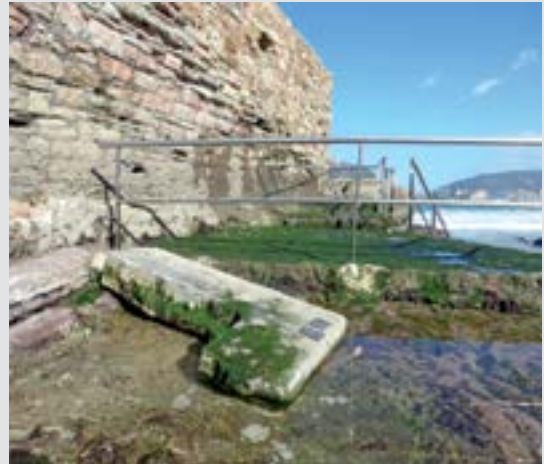
Figura 7.3. Tramo de plataforma de hormigón desprendido dos años antes (13-02-2016).
