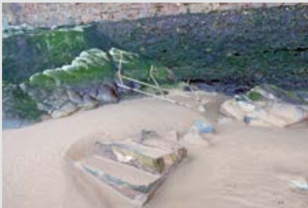
Figura 7.4. Barandilla y tramos de escalera desprendidos dos años antes (13-02-2016).
